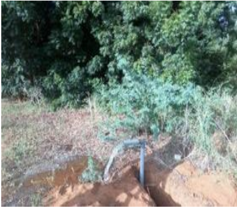
Image : Borne de fin réseau en marche
