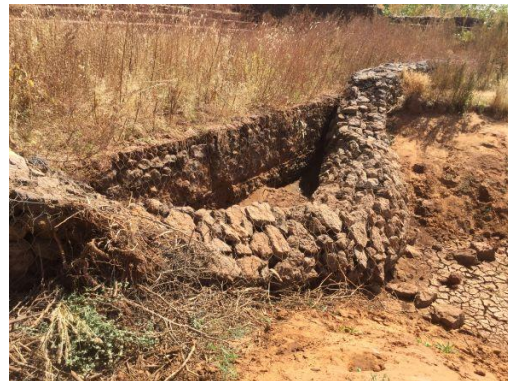
Photo 6 : Déformation de gabions
