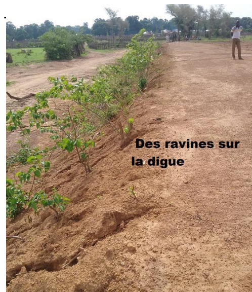
Photo 4 : Griffes d'érosion sur digue
