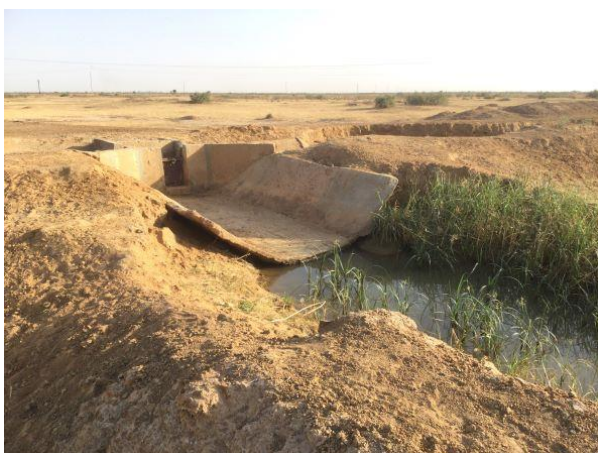
Photo 17 : Affouillement en aval d'un radier de canal
