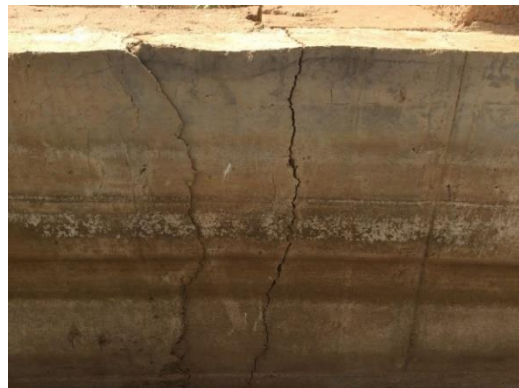
Photo 5: Fissures dans la masse d'un ouvrage en béton
