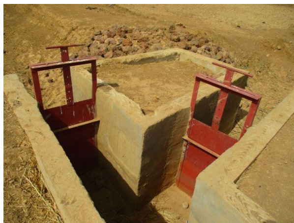
Photo 18 : Vannettes métalliques sur un partiteur
