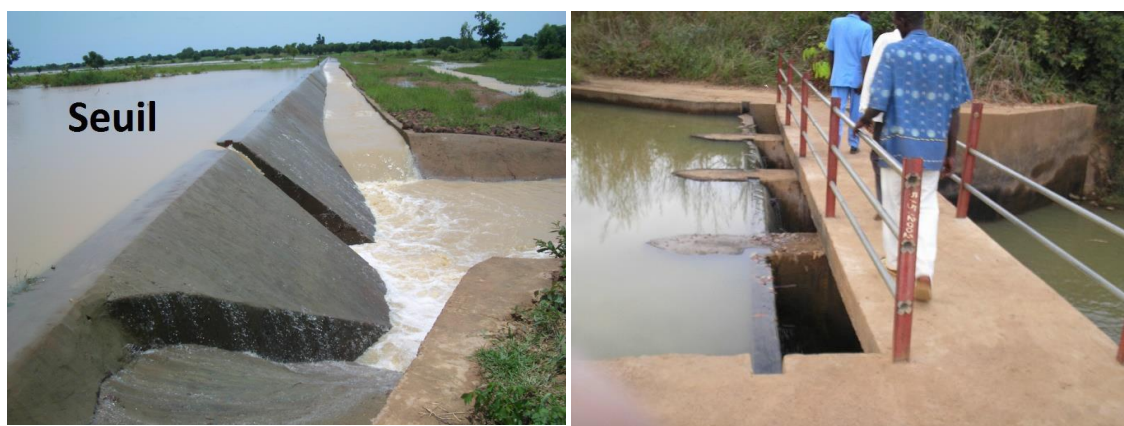
Photo 21 : Régulateurs de niveau d'eau
