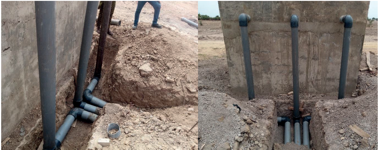
Photo 6 : vues de profil et de face de conduites de distribution en PVC
