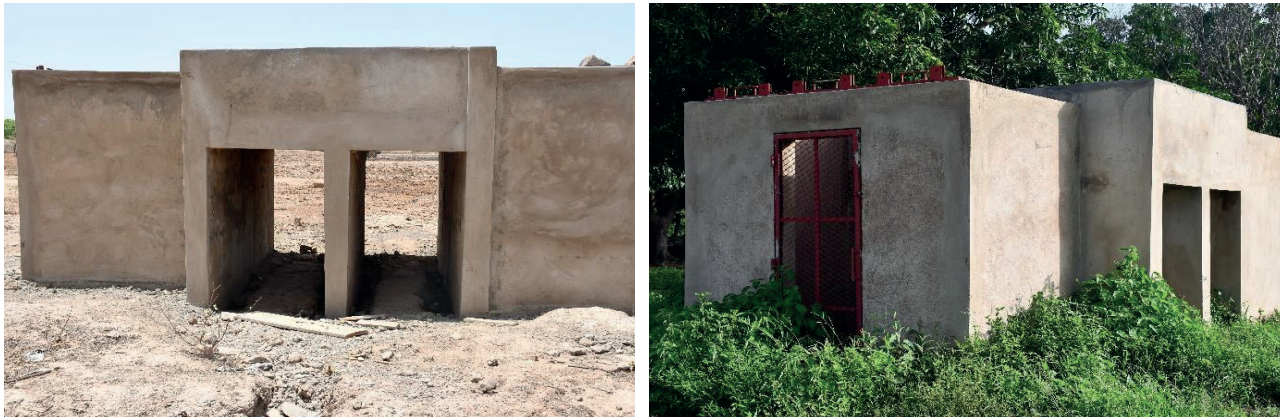
Photo 5 : vues de Bassins partiteurs
