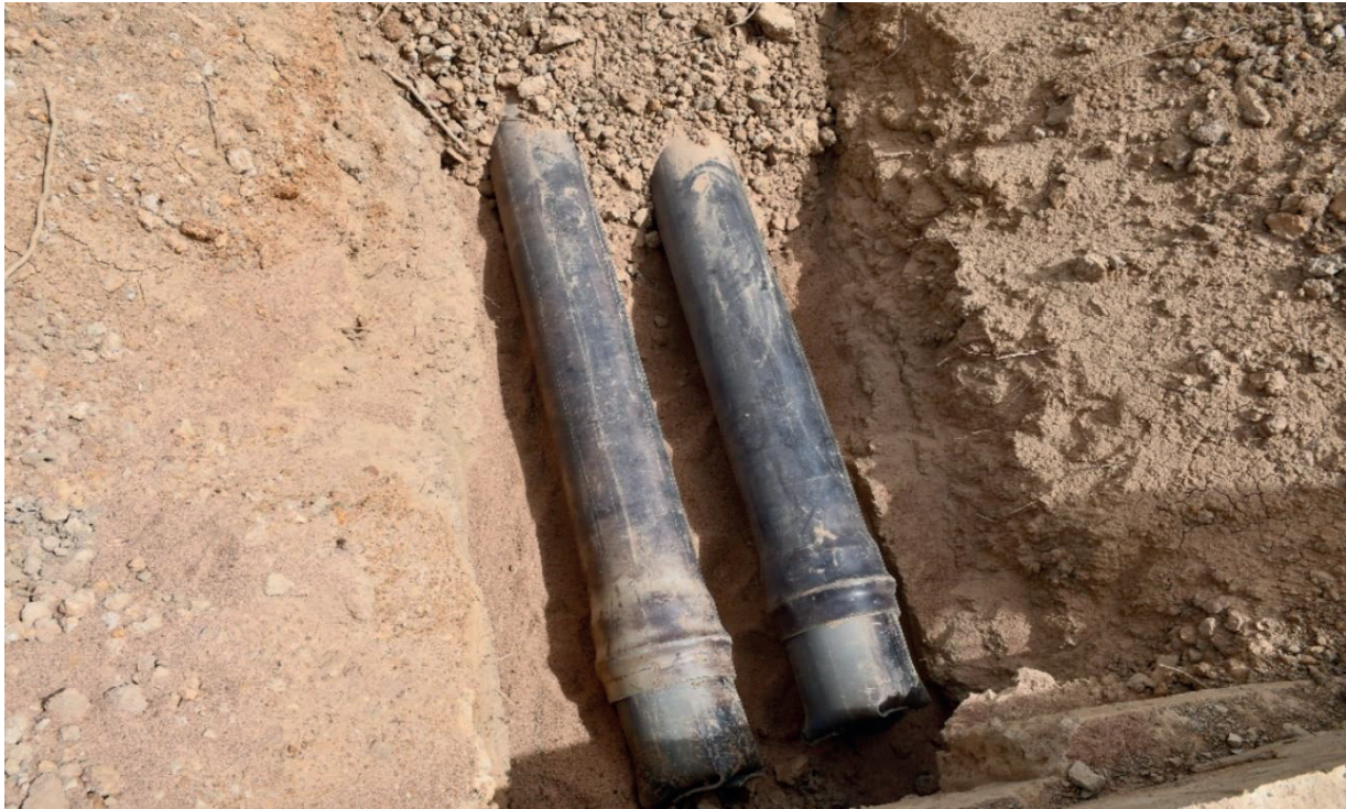
Photo 4 : Conduite PVC pression refoulement
