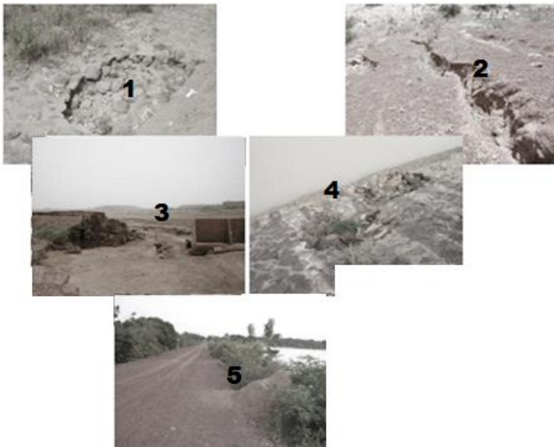
Photo 2 : Illustration de dégâts sur des barrages en terre
