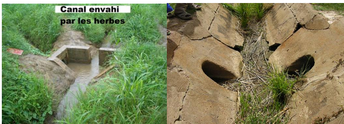
Photo 13 : Canaux bétonnés : enherbé et fissuré
