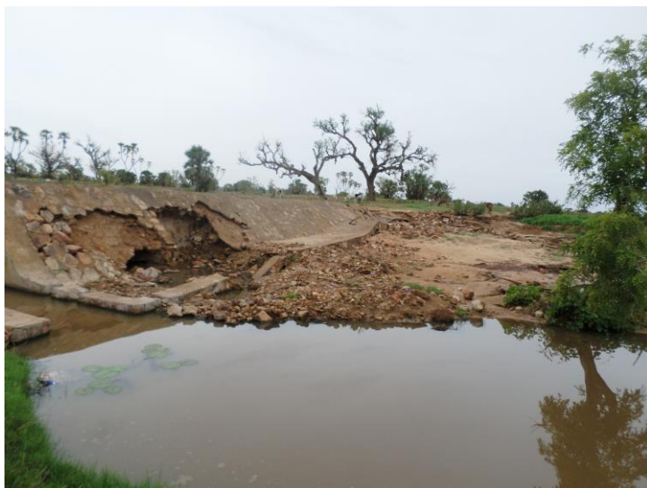
Photo 9: Eboulement sur une digue
