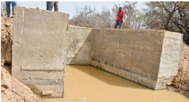
Le travaux de finition du bac de captage sur le site de Boromissi
