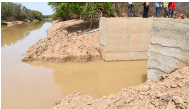
Une vue de profil du bac de captage
