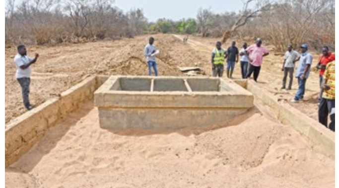
Le puits de pompage et la plateforme en cours de construction sur le périmètre irrigué de Boromissi
